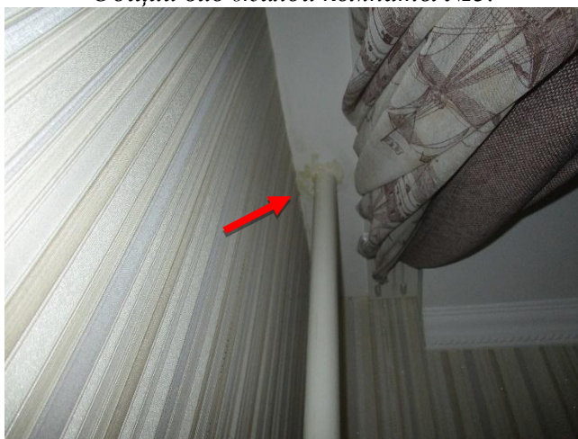
Желтые разводы в зоне трубопровода отопления.
