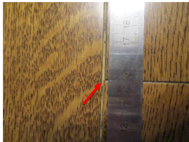
Расхождение стыков паркетной доски.
