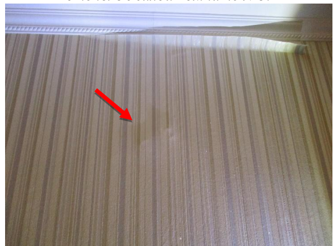
Повреждение шпаклевочного слоя под обоями на поверхности стены в жилой комнате №3.
