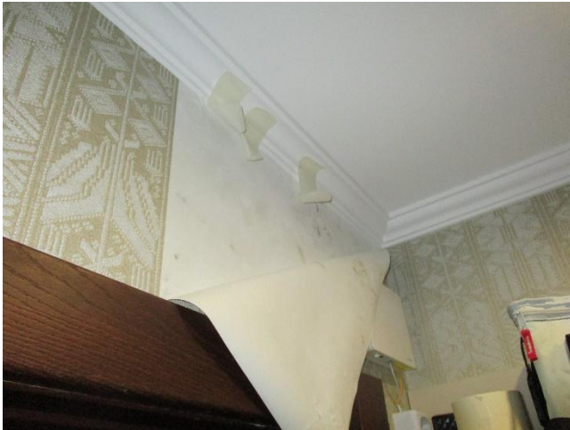
Отслоение обоевых полотен от поверхности стены над входной дверью.
