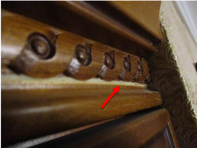
Поврежденный плинтус кухонного гарнитура.
