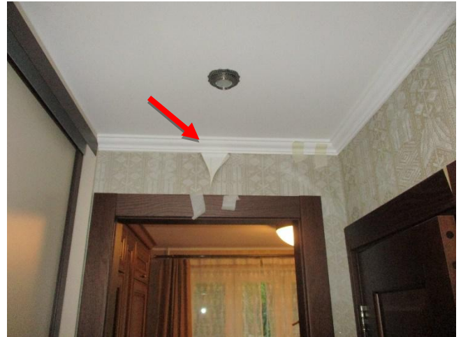
Отслоение обоевых полотен от поверхности стены над дверным проёмом на кухню.
