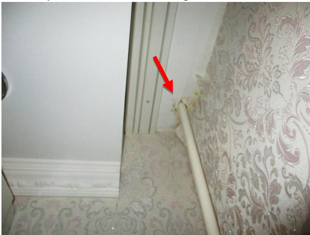
Желтые разводы в зоне трубопровода отопления.
