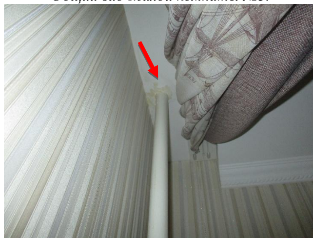
Желтые разводы в зоне трубопровода отопления.
