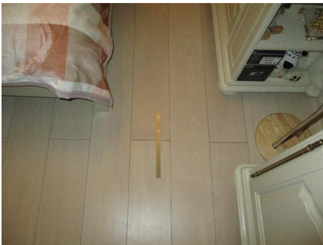
Общий вид поврежденного участка напольного покрытия.
