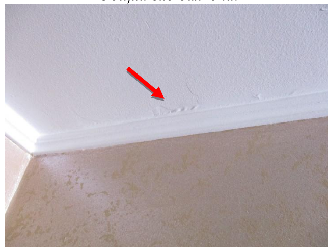
Повреждения окрасочного слоя на поверхности потолка.
