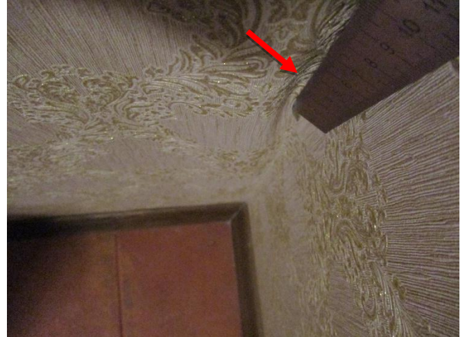
Отставание обоев от поверхности стены.
