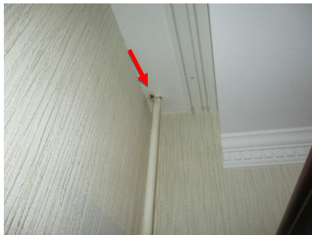
Желтые разводы в зоне трубопровода отопления.
