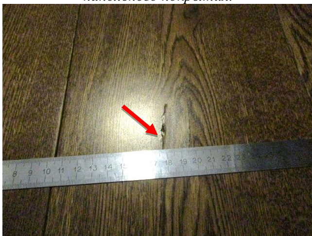
Разрушение облицовочного слоя паркетной доски.
