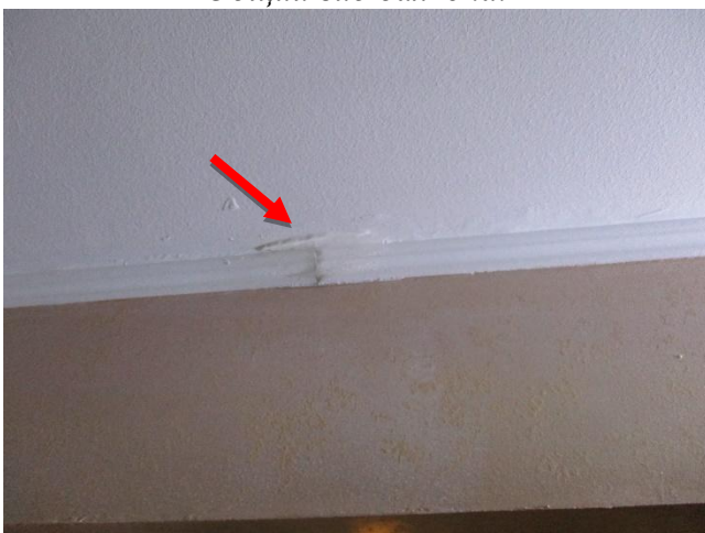
Повреждения окрасочного слоя на поверхности потолка.
