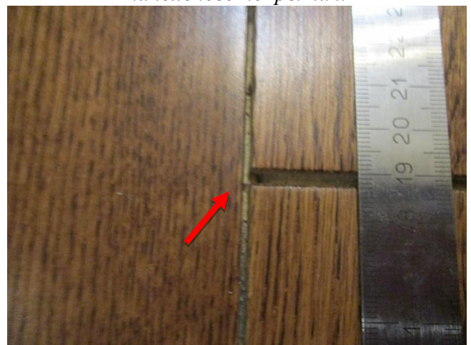
Расхождение стыков паркетной доски.
