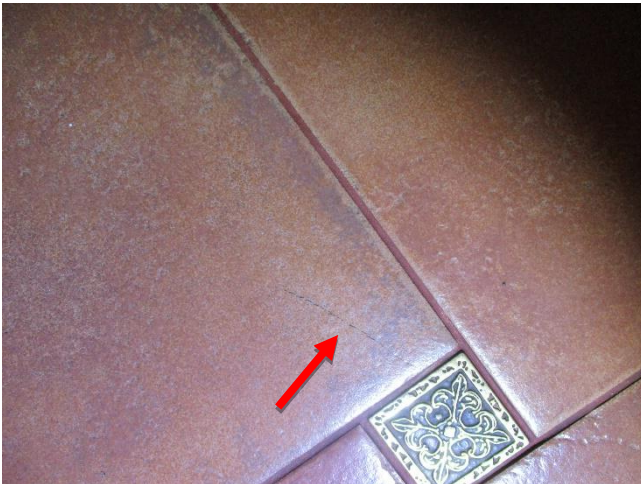
Трещина на поверхности керамической напольной плитки в кухне.
