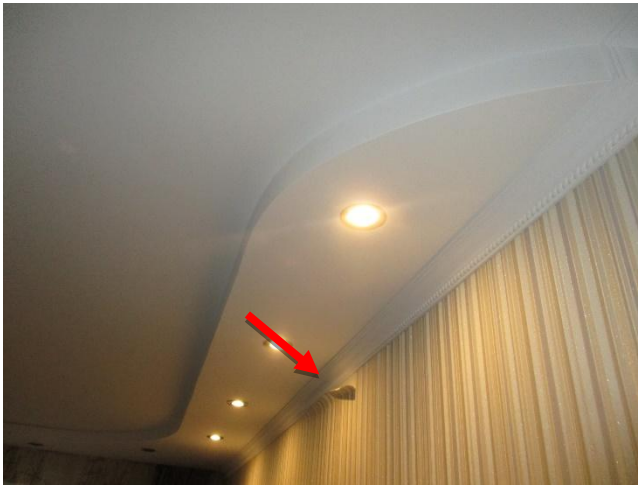
Общий вид местоположения поврежденного участка стены в жилой комнате №3.
