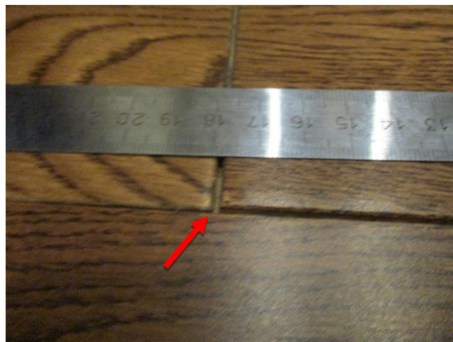
Расхождение стыков паркетной доски.
