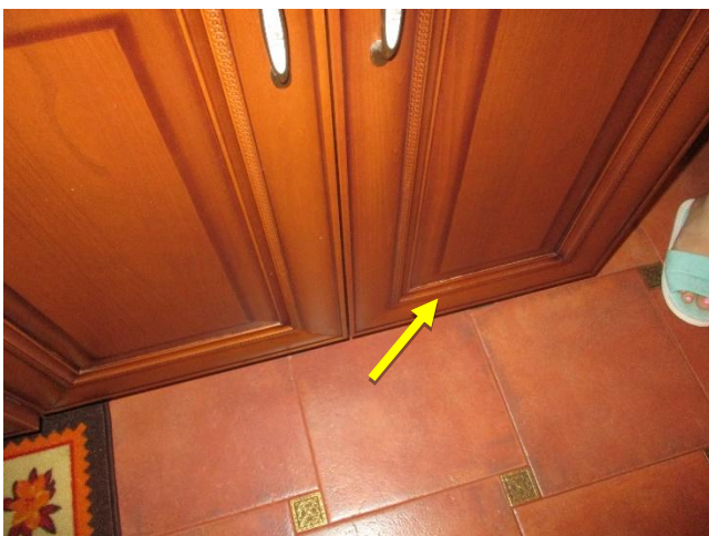
Общий вид местоположения поврежденного участка кухонного гарнитура.
