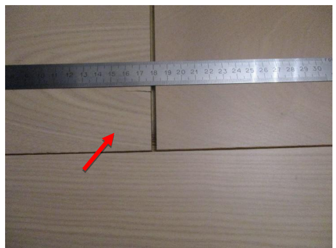
Расхождение стыков паркетной доски.
