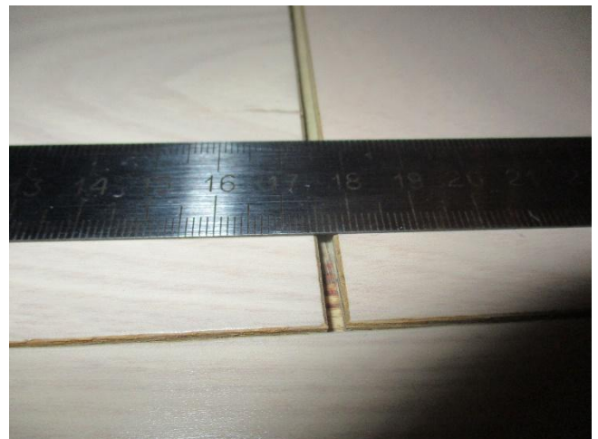
Расхождение стыков паркетной доски.
