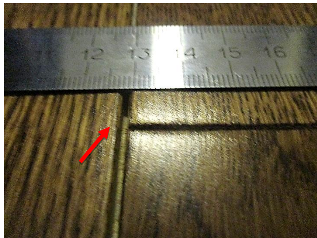
Расхождение стыков паркетной доски.
