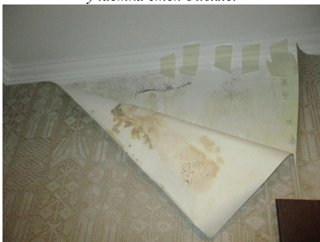
Наличие темных пятен на поверхности стены похожих на плесень (грибок).
