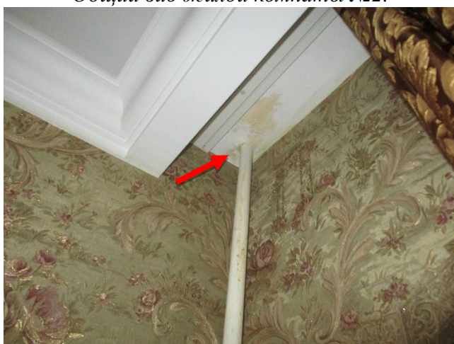
Желтые разводы в зоне трубопровода отопления.
