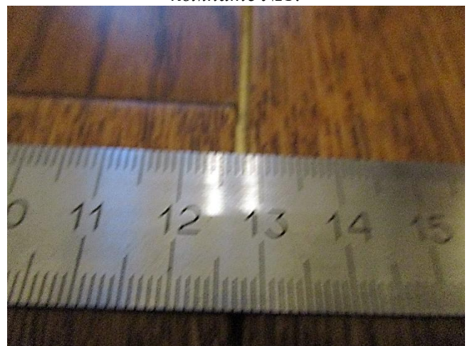
Расхождение стыков паркетной доски.
