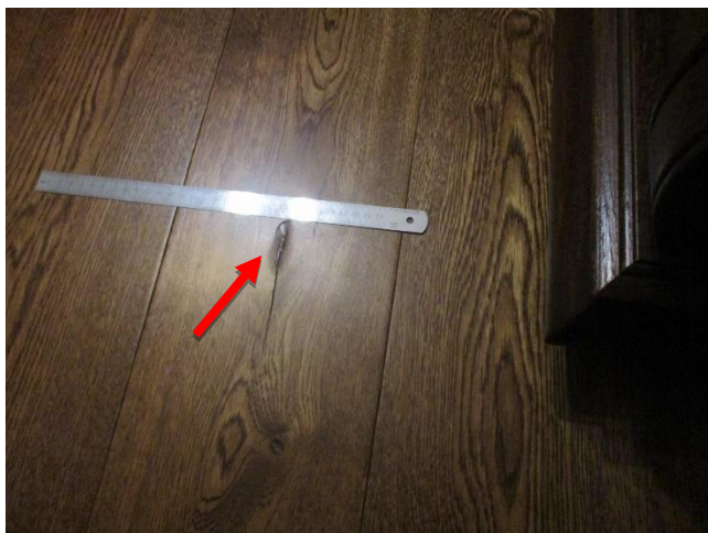
Общий вид поврежденного участка напольного покрытия.
