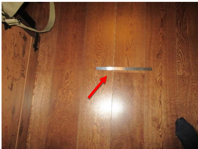
Общий вид поврежденного участка напольного покрытия.
