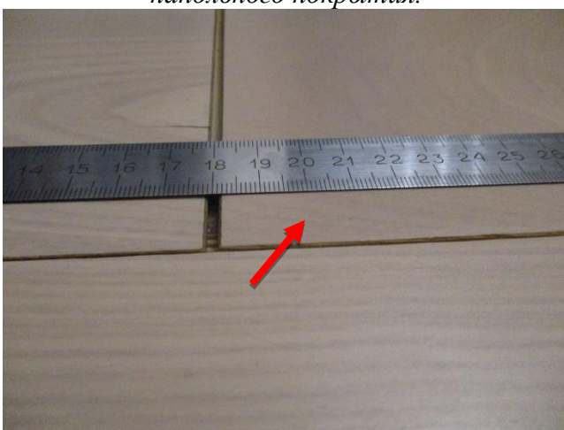
Расхождение стыков паркетной доски.
