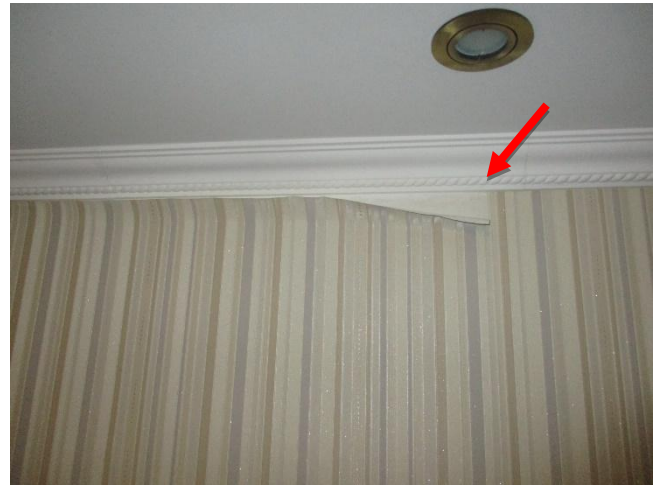
Отслоение обойных полотен от поверхности стены в жилой комнате №3.
