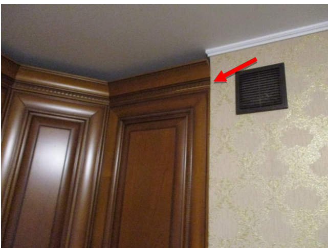
Общий вид местоположения поврежденного участка кухонного гарнитура.
