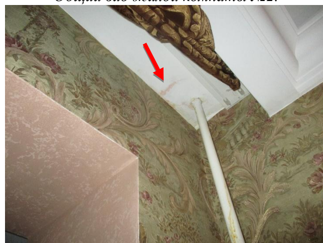
Желтые разводы в зоне трубопровода отопления.
