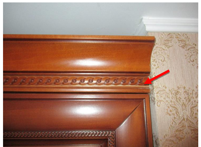
Общий вид местоположения поврежденного участка кухонного гарнитура.
