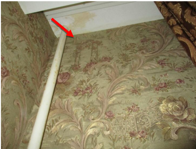
Общий вид местоположения поврежденного участка стены в жилой комнате №2.
