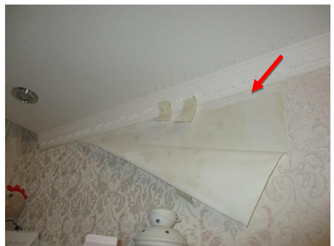
Отслоение обойных полотен от поверхности стены в жилой комнате №4.
