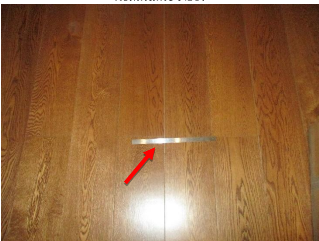
Общий вид поврежденного участка напольного покрытия.
