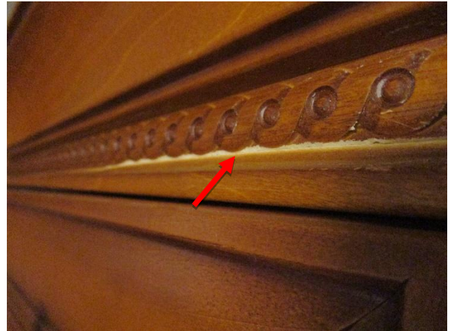
Поврежденный плинтус кухонного гарнитура.
