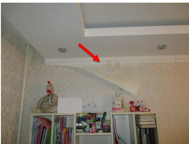
Общий вид местоположения поврежденного участка стены в жилой комнате №4.
