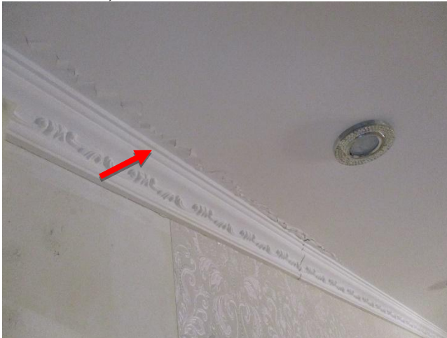
Вздутие и отслоение окрасочного слоя.
