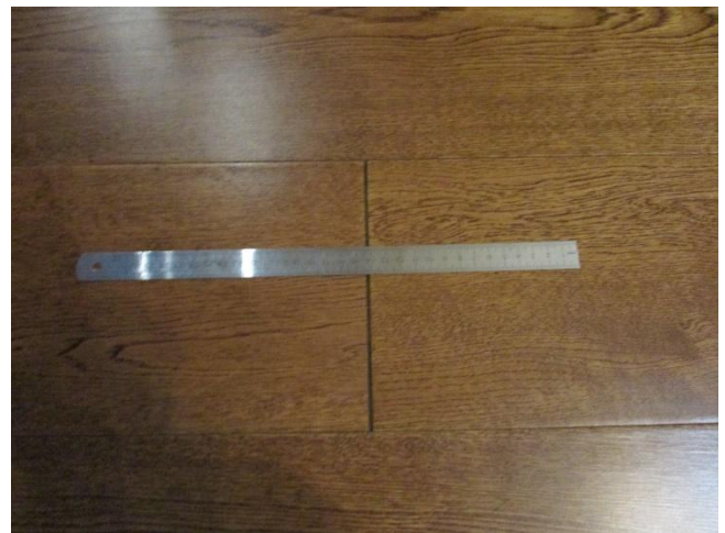
Общий вид поврежденного участка напольного покрытия.
