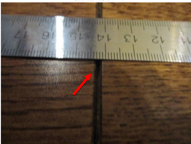
Расхождение стыков паркетной доски.
