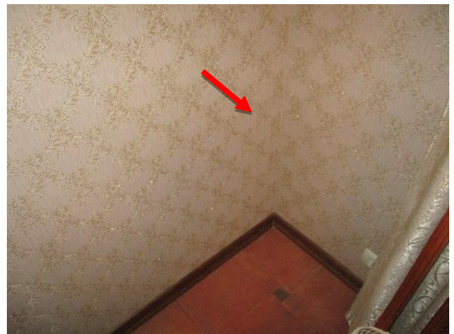
Общий вид поврежденного участка.
