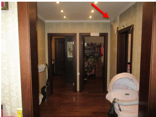
Общий вид местоположения поврежденного участка стен в холле.
