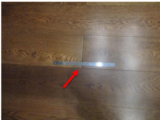
Общий вид поврежденного участка напольного покрытия.
