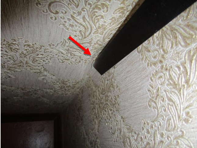
Отставание обоев от поверхности стены.
