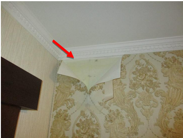
Общий вид местоположения поврежденного участка стены в жилой комнате №1.
